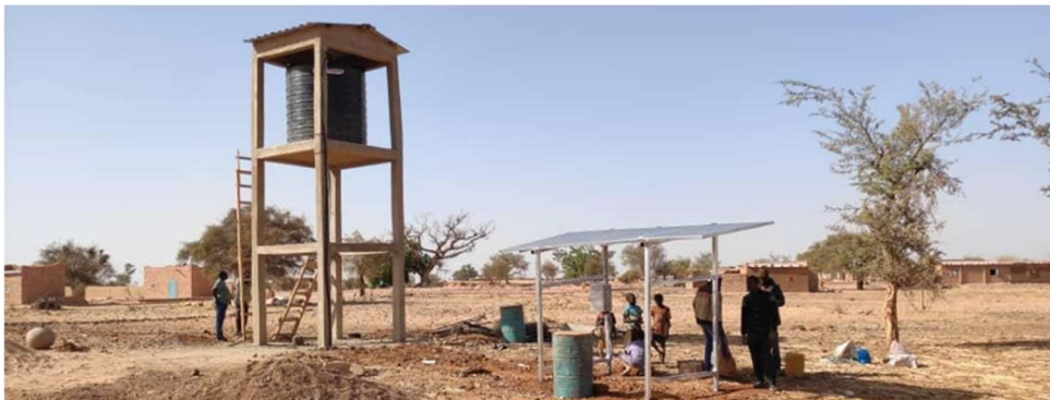
Einer der Brunnen im Bau, die im Rahmen der Klimapartnerschaft erstellt wurden
